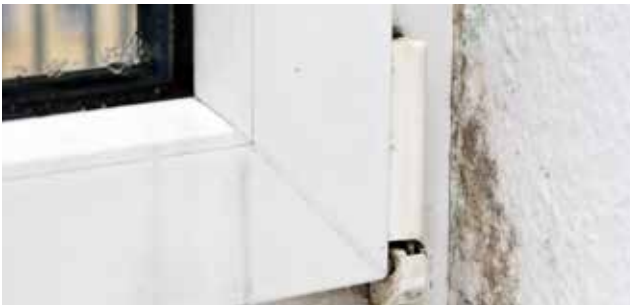
Im Winter hinter Möbeln und in Zimmerecken auf Schimmelbefall achten.
