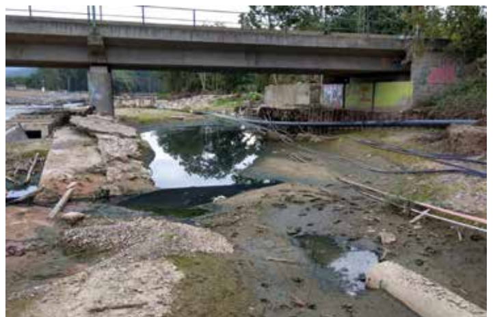
Schäden am Abwassersystem in Sinzig nach dem Hochwasser im Juli 2021. Fotos: Universität Göttingen/Michael Dietze
