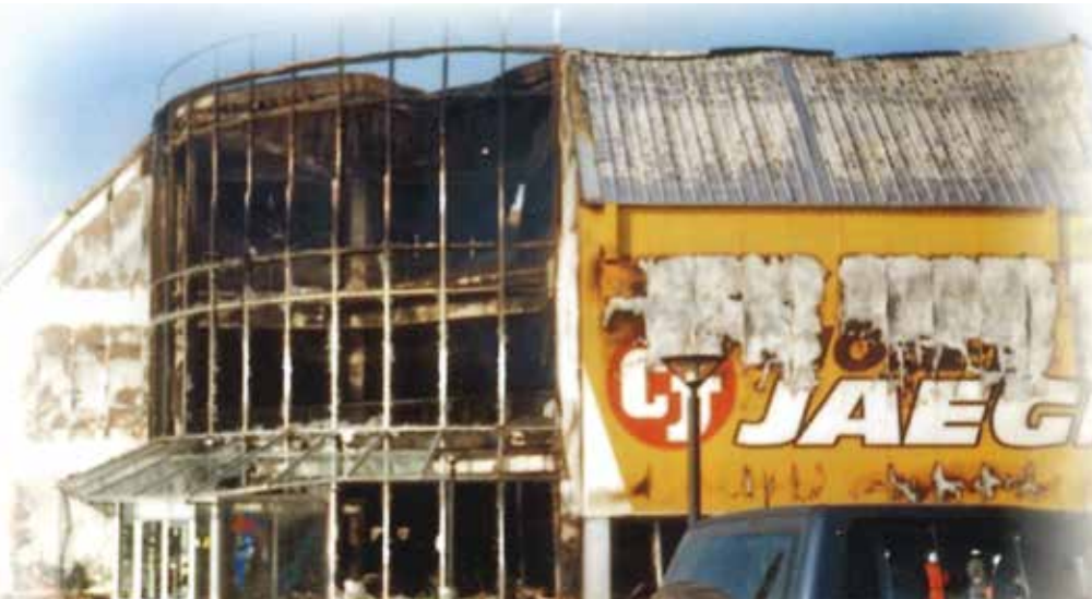
Auch von außen zeigte sich das ganze Ausmaß der Katastrophe: Das Möbelhaus in Oberdorla war durch das Feuer schwer beschädigt. Für Bernd und Gül Jaeger bedeutete der Brand einen tiefen Einschnitt – zugleich aber den Beginn eines mutigen Neuanfangs.
