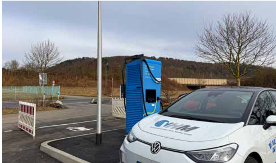
Am Pendlerparkplatz in Hedemünden sind zwei Schnellladestationen mit insgesamt vier Ladepunkten in Betrieb gegangen. Ladeleistung bis zu 400 kW. Fotos: Kuke
