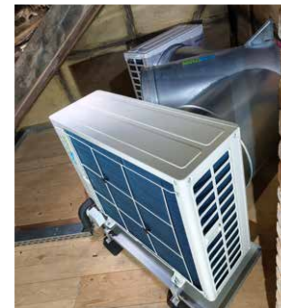
Die Außengeräte der Wärmepumpen stehen nicht sichtbar vor dem Haus, sondern auf dem Dachboden des Fachwerkgebäudes.
