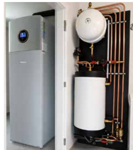
Die moderne Wärmepumpentechnik ist kompakt im Gebäudeinneren untergebracht und versorgt das historische Fachwerkhaus effizient mit Wärme.
