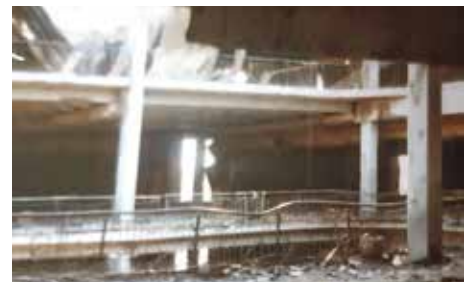
Nach dem Großbrand bot sich im Inneren des Möbelhauses ein Bild völliger Verwüstung. Ausstellung, Einrichtung und Warenbestand waren nahezu vollständig zerstört – zurück blieben ausgebrannte Räume und die Frage, wie es weitergehen sollte.
