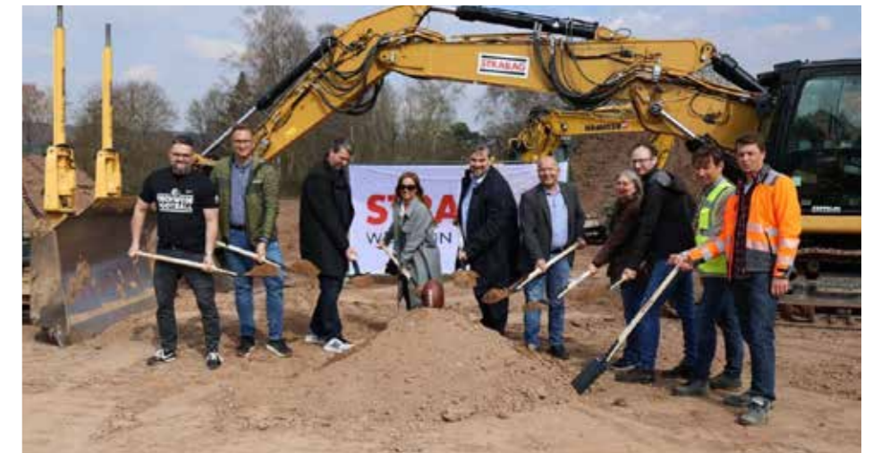
Mit dem Spatenstich startet die Umgestaltung der Torwiese zur modernen Sport- und Bewegungslandschaft. Foto: Stadt Eschwege
