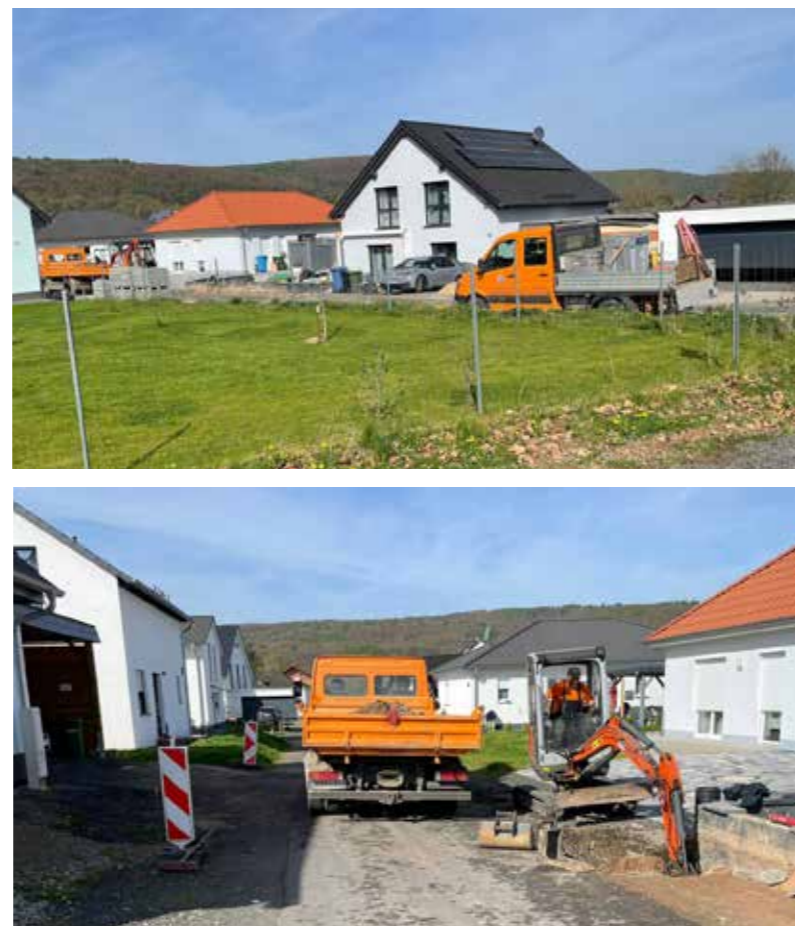
In den kommenden Wochen werden die Enderbeiten am Baugebiet Gimte 1 abgeschlossen sein. Hier werden Borde gesetzt und Straßenlaternen installiert.
